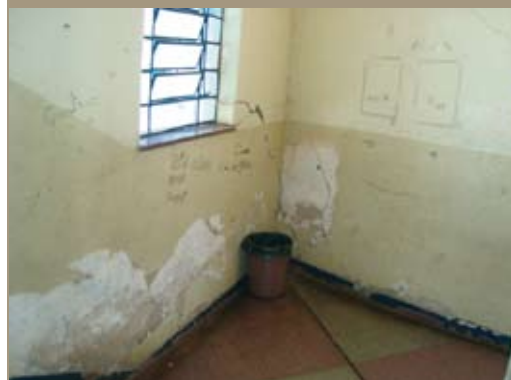
Pintura deteriorada e trinca na parede
