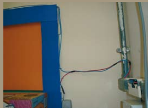
Fiação elétrica aparente: improvisação
