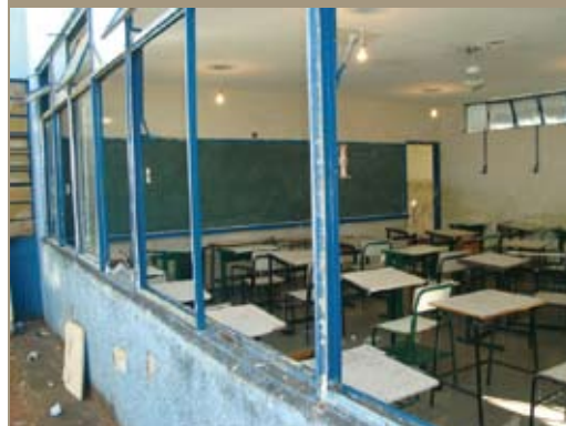
Vidros totalmente quebrados, umidade nas paredes e tetos
