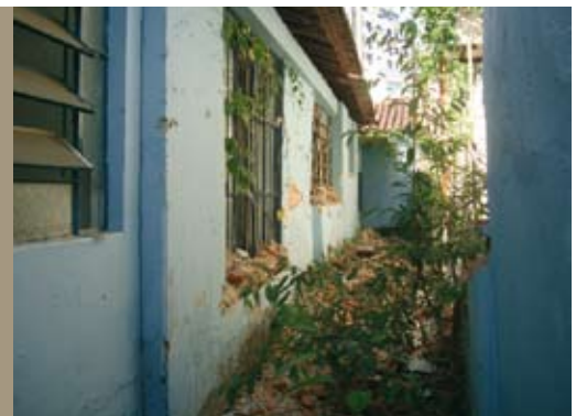
Muro desabou, atingindo uma sala de aula
