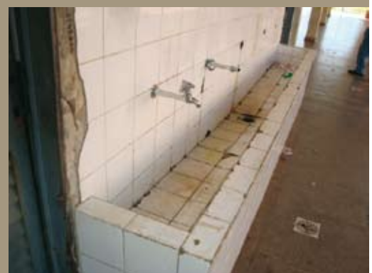
Bebedouro dos alunos com azulejos quebrados e manchados, faltando torneiras e outros acessórios
