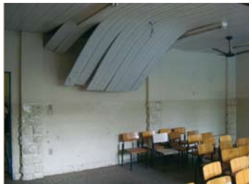
Vista interna da sala de aula, com cobertura comprometida
